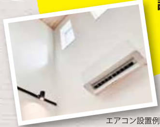
エアコン設置例
